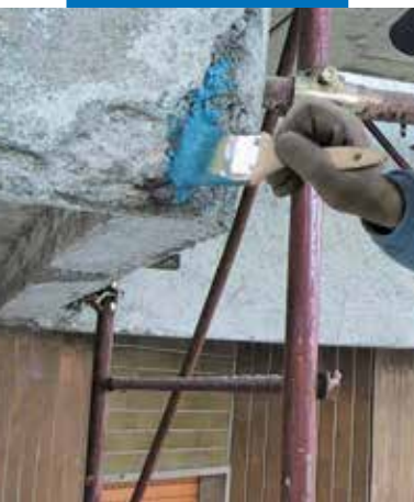
Application au pinceau de Mapefer 1K sur des armatures de balcon en béton armé
